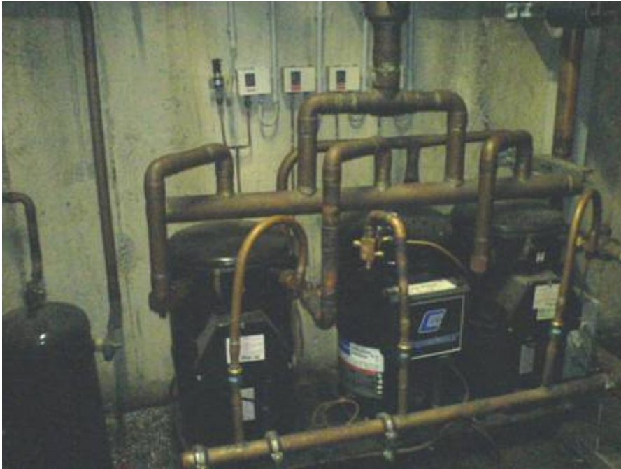
Scrollverdichter R401a Kaltwassererzeugung Kälteleistung 3 x 40 kW
