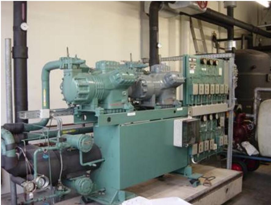
Kolbenverdichter 2 halbhermetische R22 Kälteleistung 2 x 130 kW
