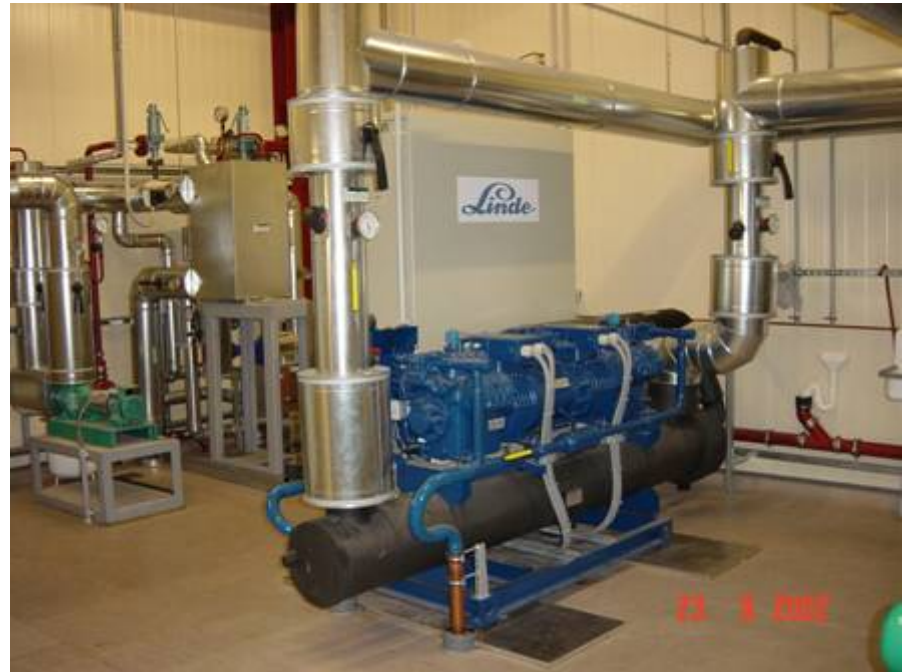
Schraubenverdichter R410a Kälteleistung 2 x 170 kW
