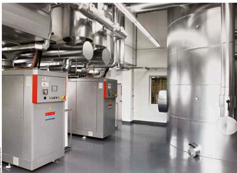
Die beiden BHKW mit separaten Abgaswärmetauschern sind über einen Schichtenspeicher in die Wärmekaskade zur Versorgung der Rohde AG eingebunden
