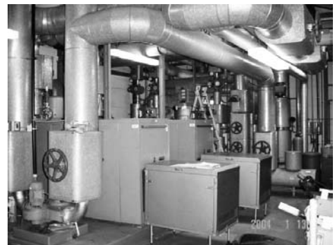
Abb. 2: Altanlage 2000 kW, Bj 1984, mit Pumpen und Rohrleitungsgewirr
