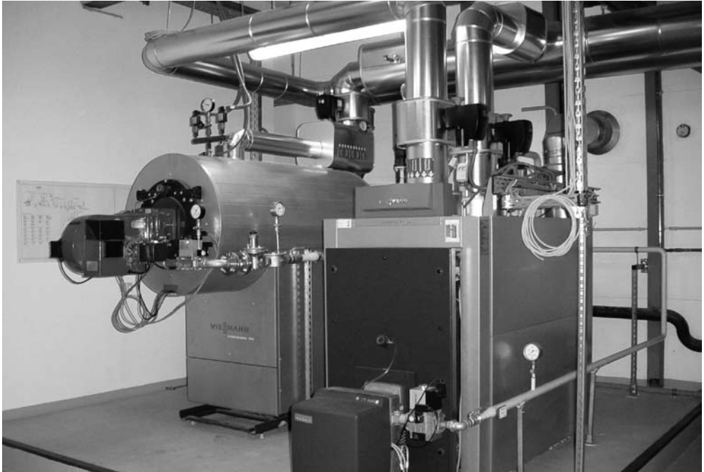
Abb. 3: Die ‚kleine‘ Wärmeerzeugeranlage; statt ‚früher‘ rund 2000 kW hier nur noch 925 kW
