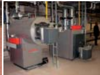
Der neue Heizkessel mit Brennwertechnik ...
