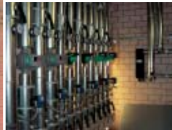
Der neue Heizungsverteiler ...
