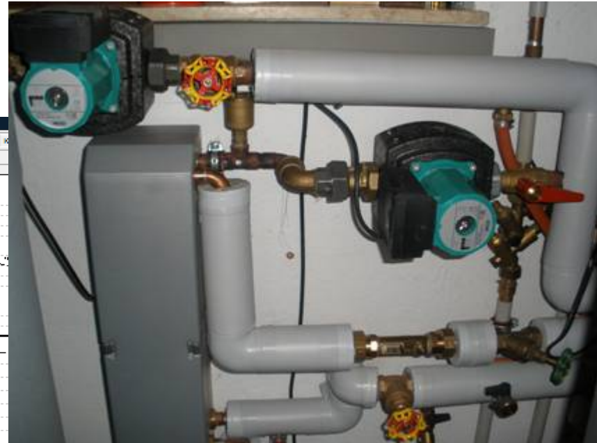
Wärmepumpenanlage mit Effizienzklasse, erstellt 2008
